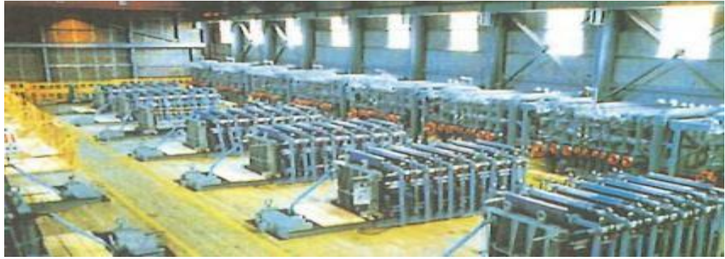
شكل 23 : جانب من وحدة صناعية لمعالجة المياه بتقنية الفرز الكهربائي
